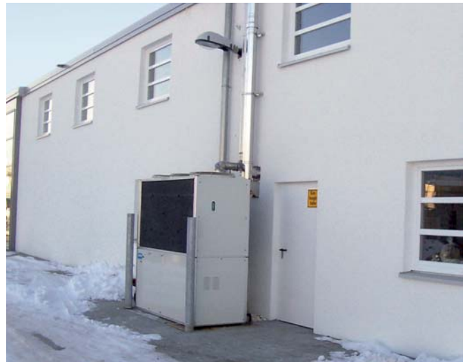
■ Die Beheizung und Klimatisierung des Autohauses erfolgt über eine Gaswärmepumpe, die als Wärmequelle neben der Umgebungsluft auch die eigene Motorabwärme nutzt.
